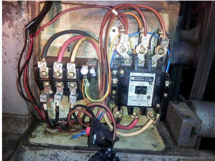
Hình 5.19 Công tắc tơ và Rơ le nhiệt trên tủ điều khiển của một máy công cụ
